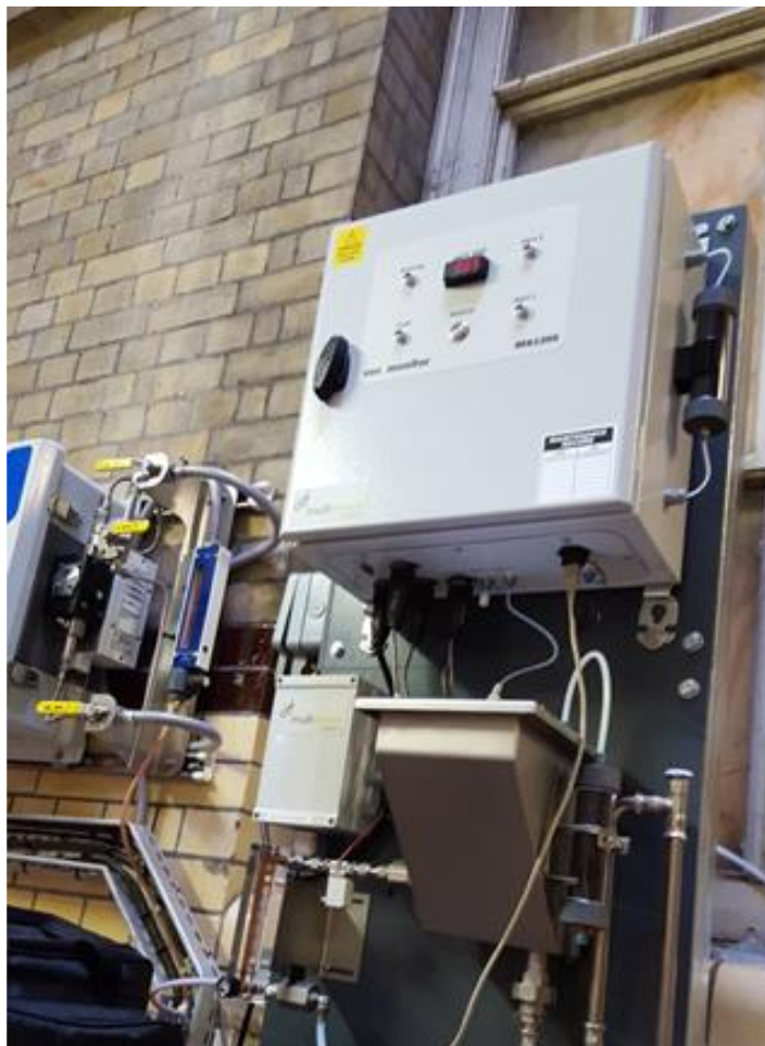
Figura 18 - MS1200 instalado en 2014
