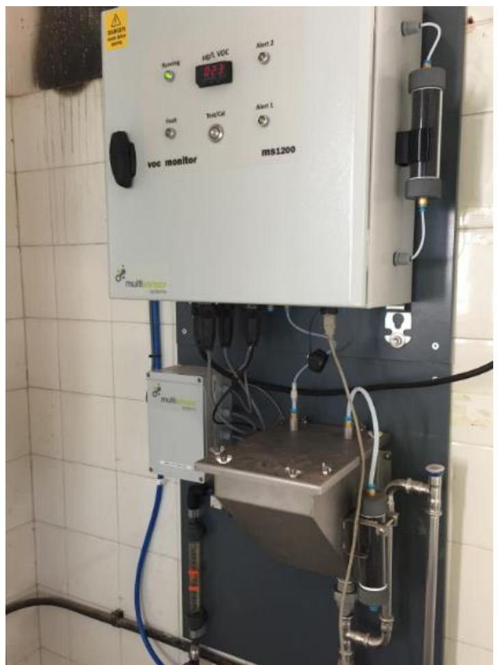
Figura 17 - Una imagen de la unidad instalada en un edificio anexo al pozo.
