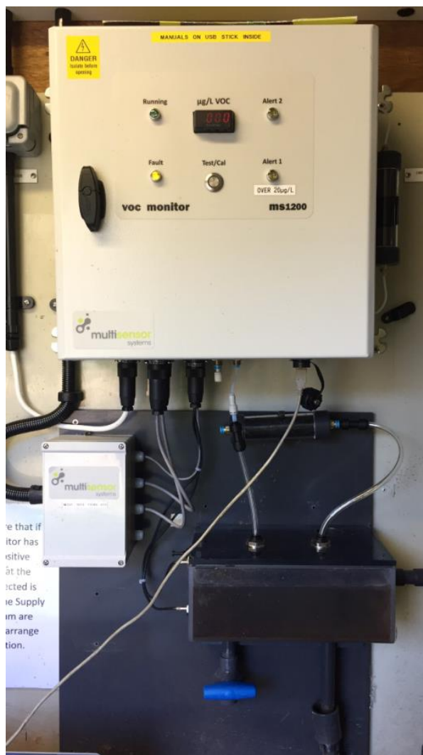
Figura 16- Una imagen de la unidad instalada en el edificio anexo. La unidad controla una compuerta que desvía el flujo del depósito en caso de contaminación.
