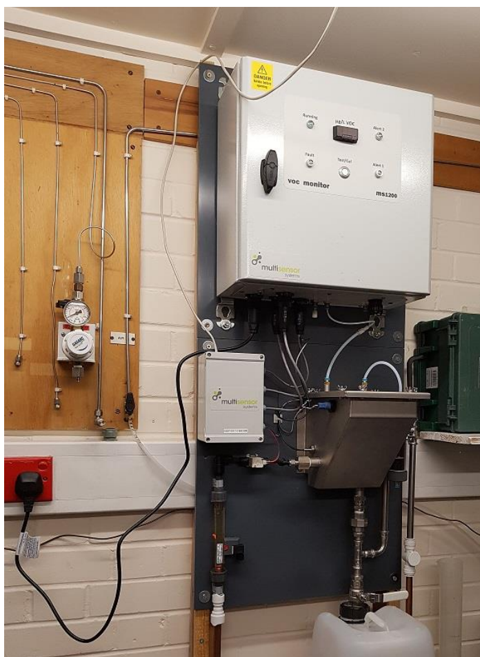
Figura 15 - Una imagen de la unidad instalada en la dependencia. La unidad está conectada a un PLC que registra los datos y, en caso de accidente, activa una alarma que apaga las bombas de aspiración.
